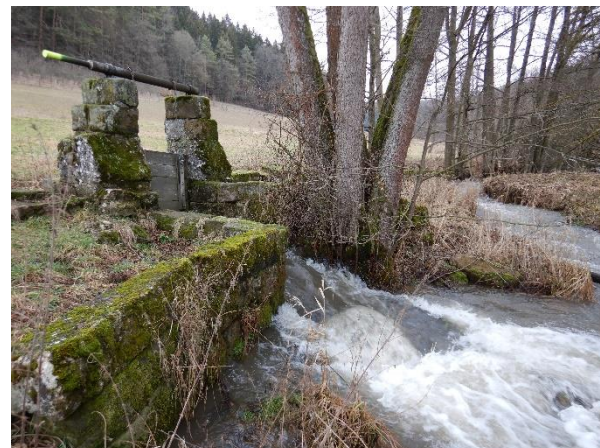
Abbildung 4: Ist-Situation an der Lochau Fkm 2,2. Mangelhaft durchgängige Fischaufstiegsanlage.
