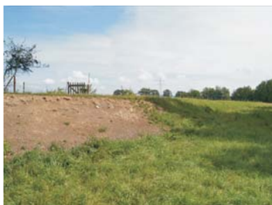
Vorhandener beschädigter Sommerdeich
