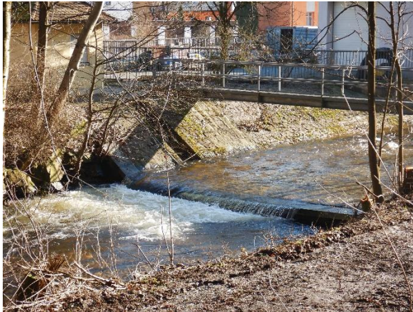
Abbildung 1: Ist-Situation in Bad Berneck Fkm 34,1. Nicht durchgängiger Absturz.
