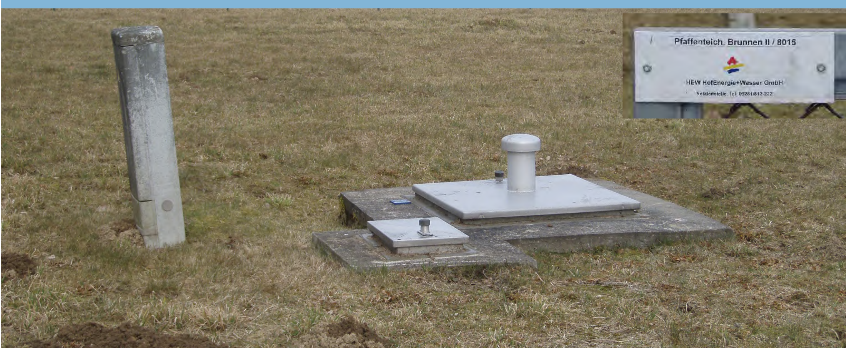
An den Pfaffenteichen (Stadt Hof): Grundwassergewinnung aus 3 Tiefbrunnen mit einer Brunnentiefe von 25 m bis 47 m. (Foto WWA Hof)
