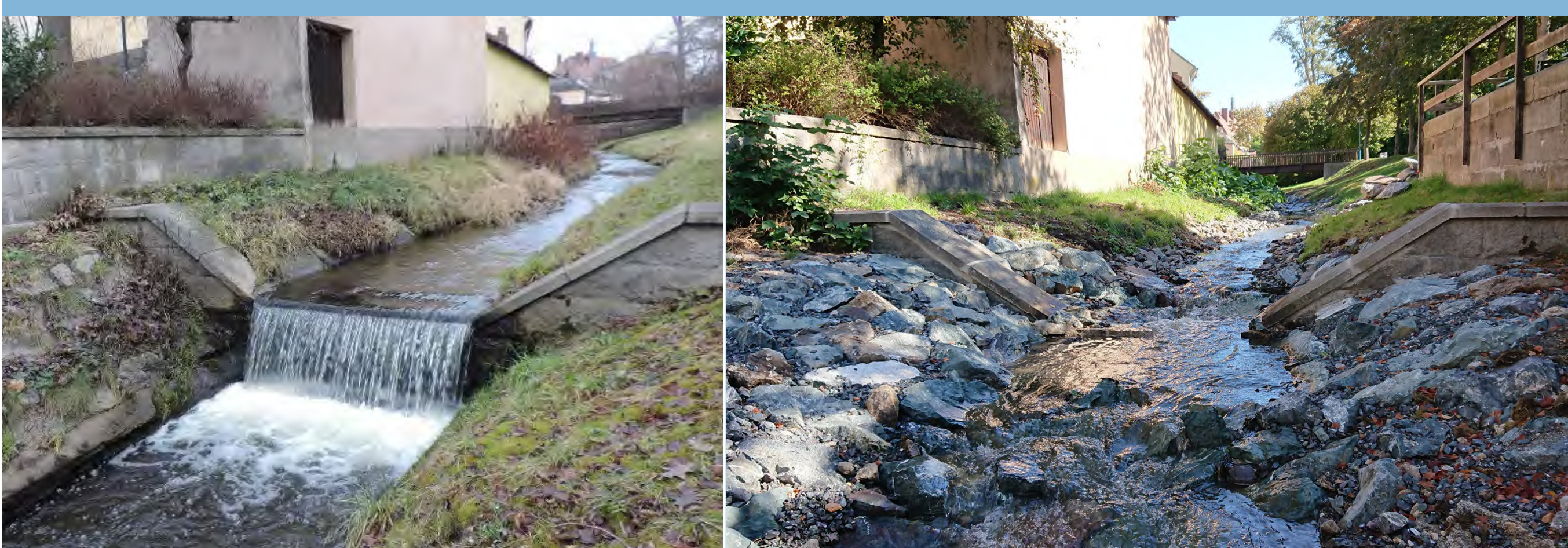
Selb 2021 - Links: der Absturz vor dem Umbau; rechts: die „raue Rampe“ ermöglicht jetzt die Durchgängigkeit für Tiere (Fotos WWA Hof)
