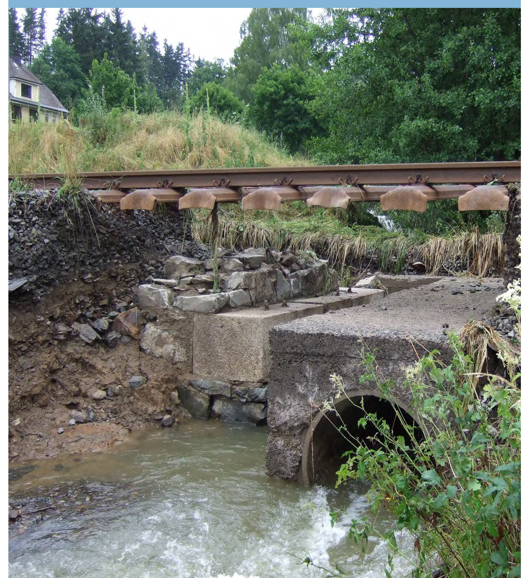
2021 - Viele Starkregenschäden sind im Umkreis von Selbitz sichtbar (Lkr. Hof). (Foto WWA Hof)
