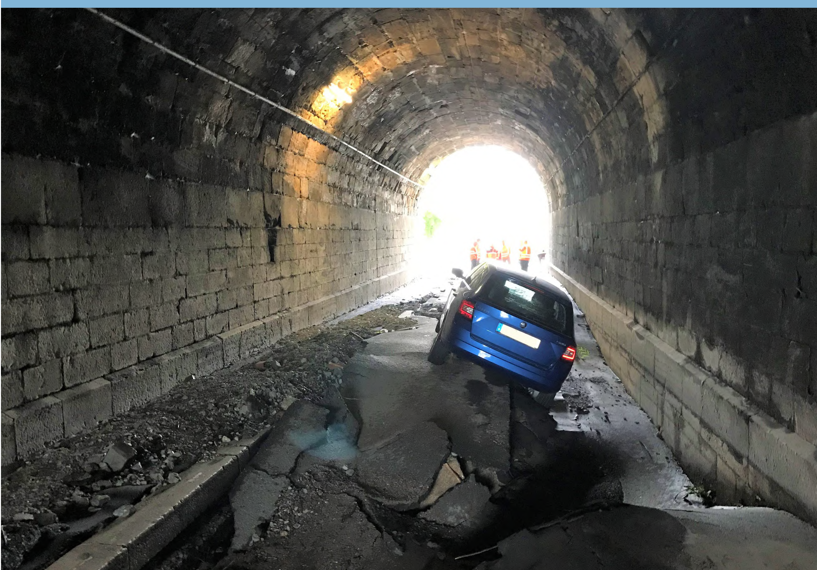
Hof am 13.07.2021 - Das viele Wasser überfordert die Kanalisation unter dem Alsenberger Tunnel. (Foto WWA Hof)
