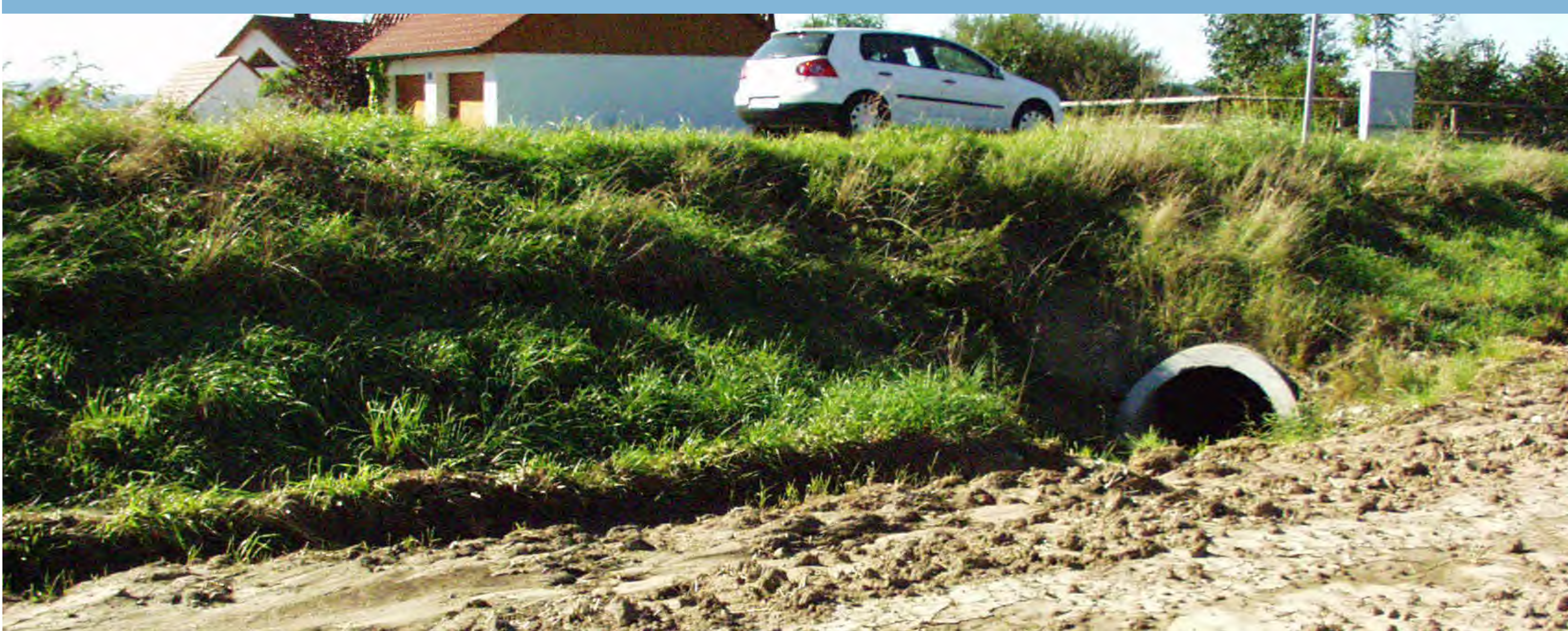
Schlamm kann ins Gewässer geschwemmt werden und große Schäden verursachen. (Foto WWA Hof)
