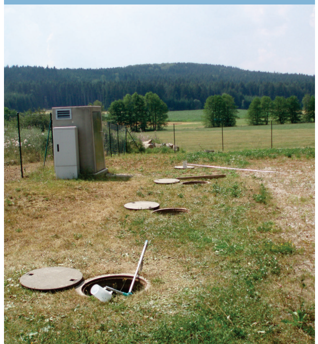
Eine Kleinkläranlage bei Reicholdsgrün im Landkreis Wunsiedel. (Foto WWA Hof)
