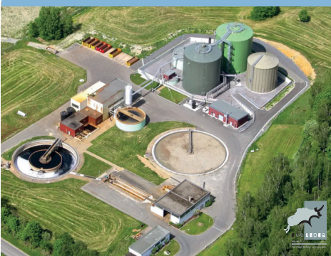
Werkseigene Kläranlage der Lederfabrik Fa. Südleder in Rehau (Lkr. Hof). (Foto Fa. Südleder)
