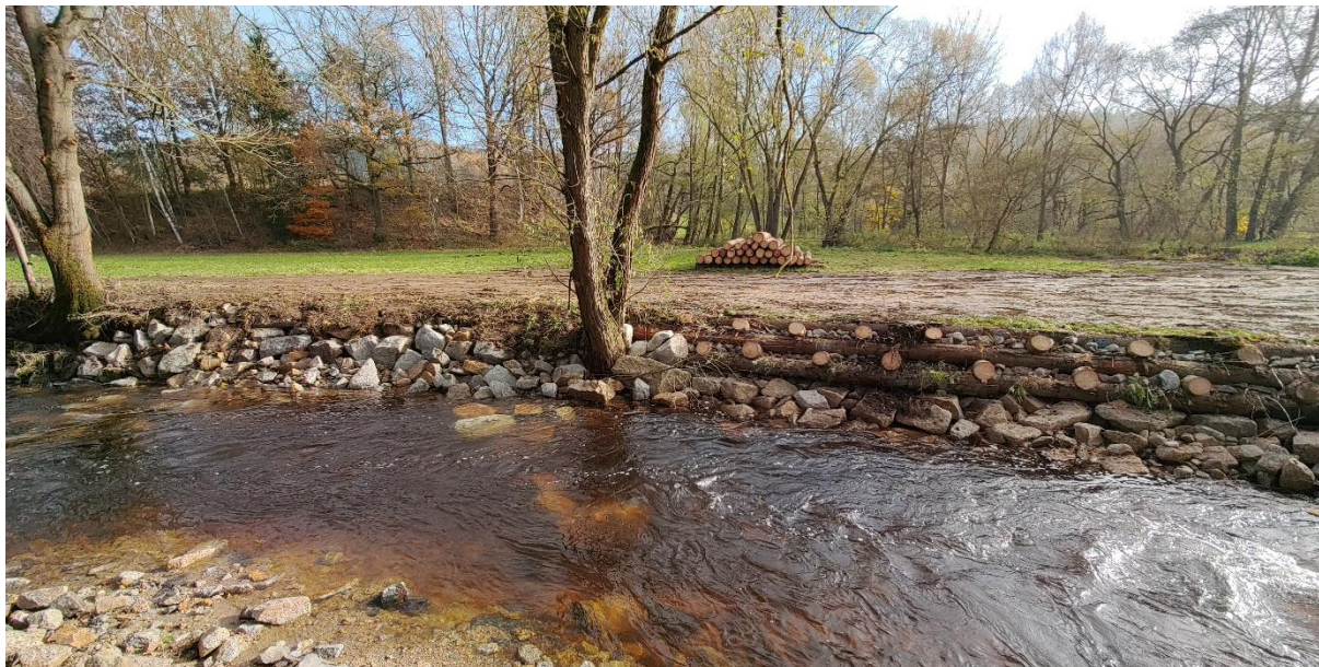
Obr. 4: Břehové opevnění na vodním toku Reslava u obce Arzberg-Oschwitz (kamenné břehové opevnění; vlevo)
